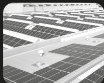
IL PARCO FOTOVOLTAICO VIENE COMPLETATO
