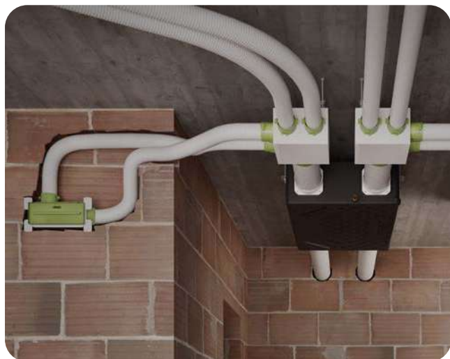
Impianto VMC completo
