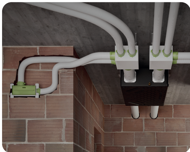
Impianto VMC completo
