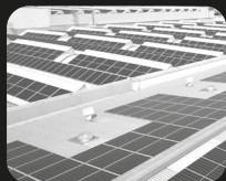
IL PARCO FOTOVOLTAICO VIENE COMPLETATO
