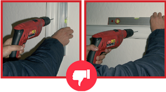
Kabelkanalinstallation ohne eingebaute Wasserwaage
