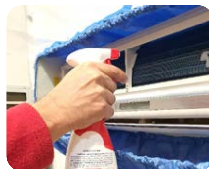
Pulizia batteria senza telo di protezione
