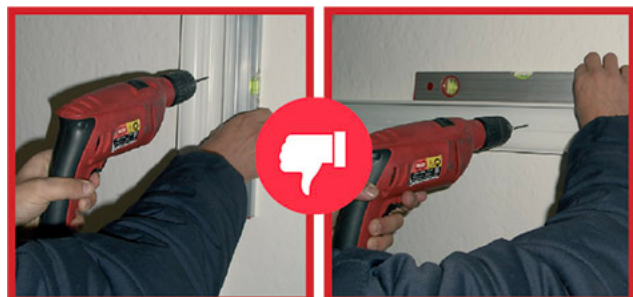
Kabelkanalinstallation ohne eingebaute Wasserwaage
